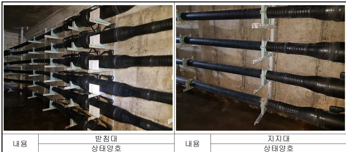
【사진 2.16】 부속 및 부대설비 현황
